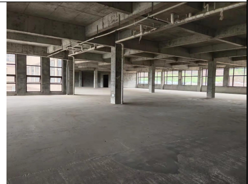
图 1-4 项目厂房内部
