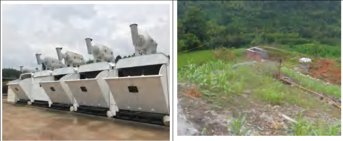
图 5.3-1 类比同类型钻井工程已建柴油发电机和放喷池现场实景图
