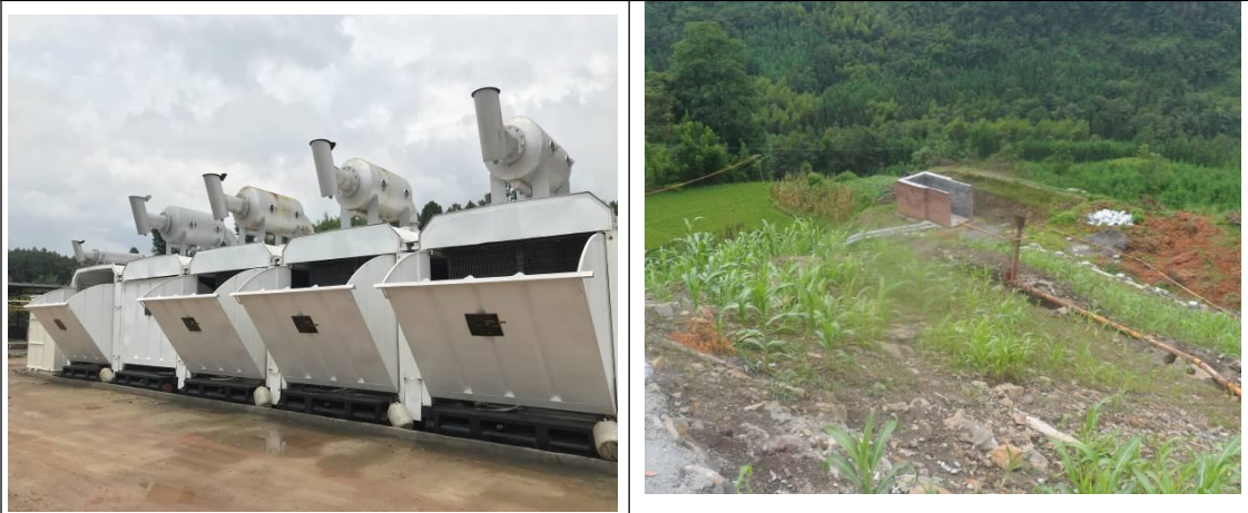
图 5.3-1 类比同类型钻井工程已建柴油发电机和燃烧池现场实景图
