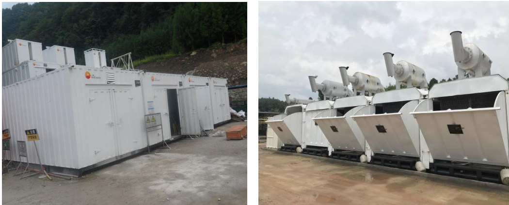
图 5.3-4 类比建设单位其他井站柴油机、发电房噪声防治措施实照
