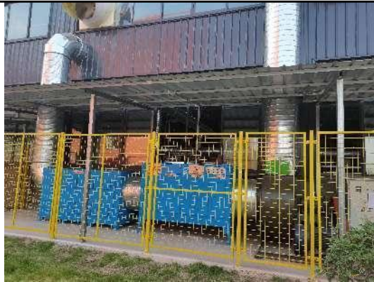
3#生产车间二级活性炭吸附装置
